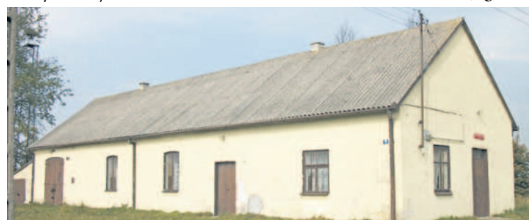
Remiza w Łąkiem doczeka się remontu prawdopodobnie w przyszłym roku
