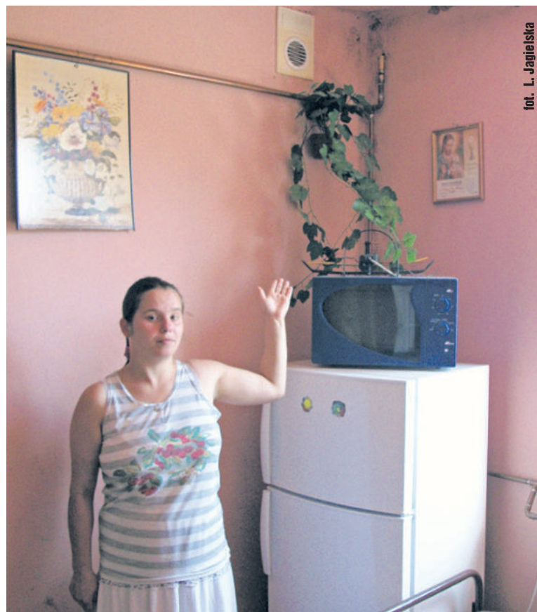
Pani Barbara pokazuje zagrzybione ściany w kuchni
