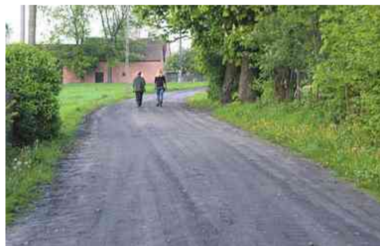
Blisko kilometrowy odcinek drogi gminnej od wielu lat czeka na remont
