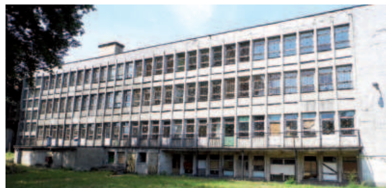
Stan budynku pogarsza się z dnia na dzień
