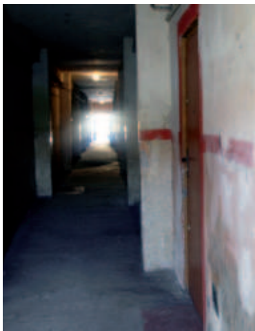
Na pierwszy rzut oka widać, że budynek przy Komunalnej 4 jest w kiepskim stanie
