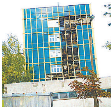
Zniszczona ściana przypomina o sobotnim pożarze
