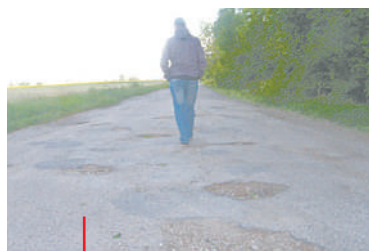
Droga w Kisielewie przypomina szwajcarski ser – dziura na dziurze
