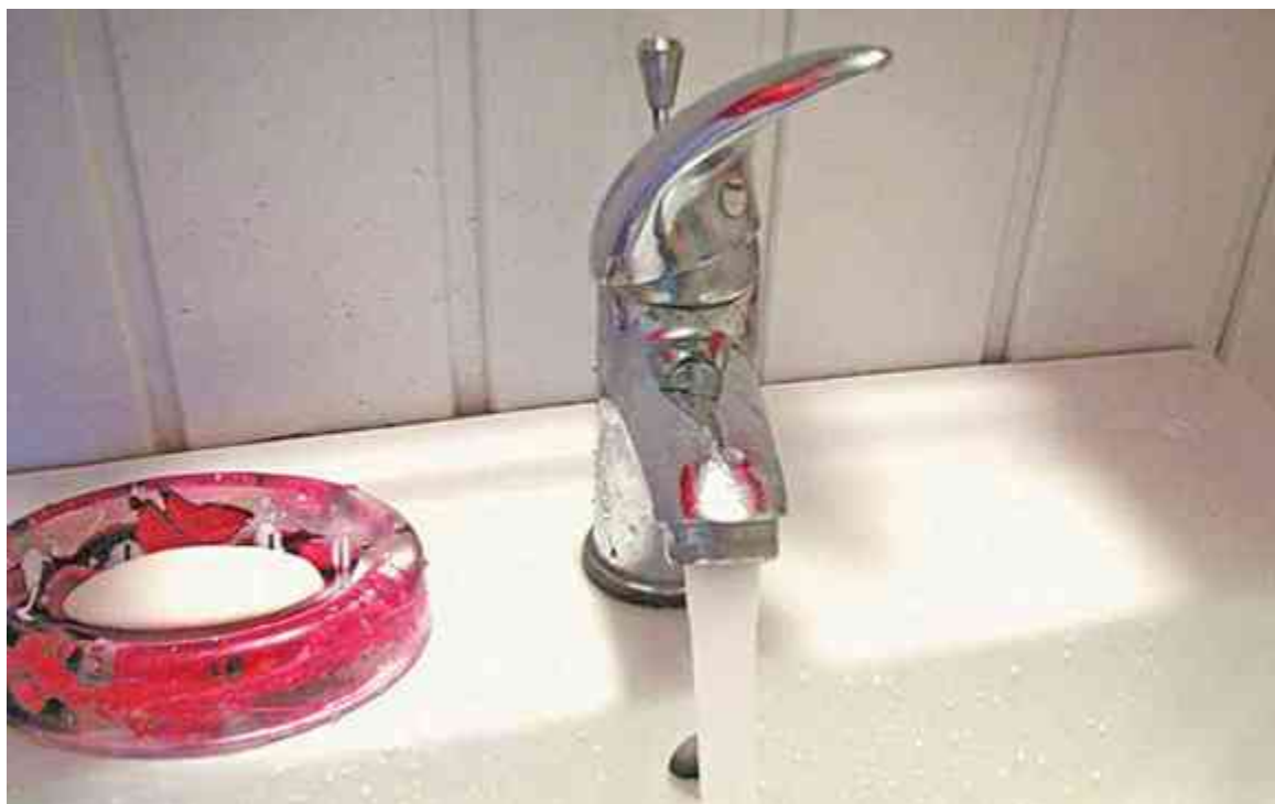
Woda z kranów w Lipnie od kilku dni jest niezdatna do użytku
