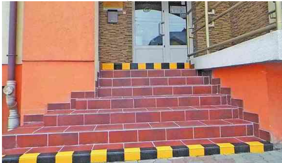
Schody do urzędu po poprawkach spełniają już wszelkie wymogi bezpieczeństwa
