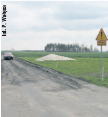
Na początku ul. Wiejskiej stoi znak, informujący o zmianie nawierzchni asfaltowej. Na wiele gorszą.
