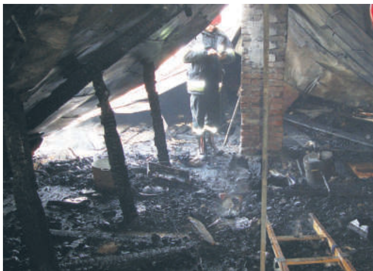
Tak wyglądał strych budynku tuż po ugaszeniu pożaru
