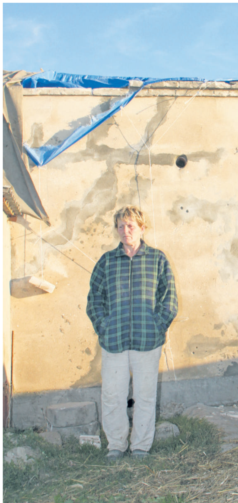
Maria Maćkiewicz z Sumina przy budynku gospodarczym, z którego wiatr zerwał dach
