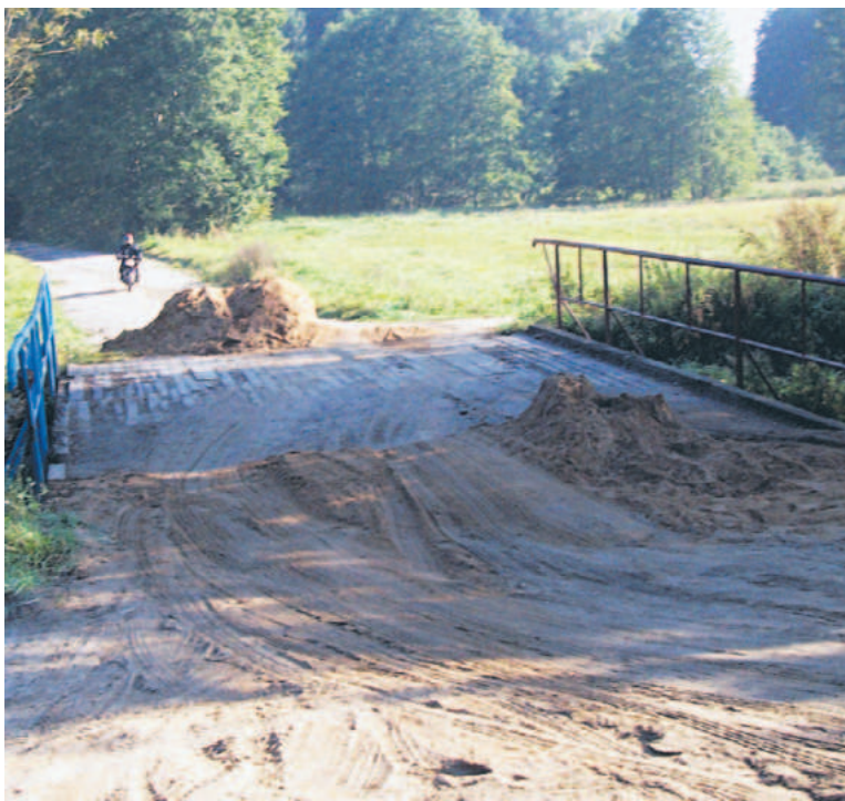
Przejazd przez uszkodzony most jest możliwy
